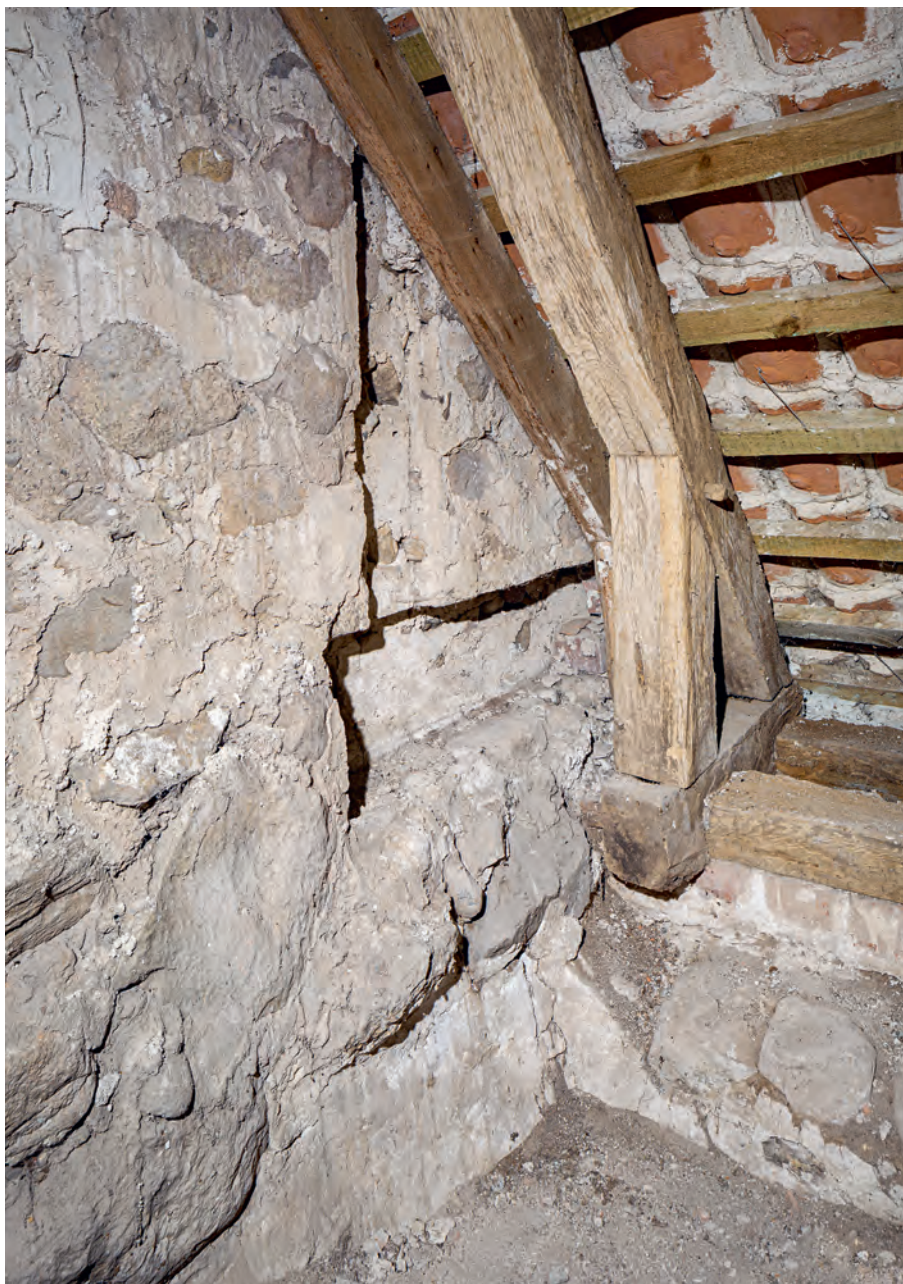
Fig. 48. Spor efter et gavlspær med spærfod og kort lodret spærstiver i skibets østgavls østside (s. 6029), set fra korets tagrum samt puds på korets overmur (s. 6002). Foto Arnold Mikkelsen 2020. – Traces of a gable rafter with rafter foot and short, vertical rafter strut in the east side of the chancel loft as well as plaster on the upper wall of the chancel.
